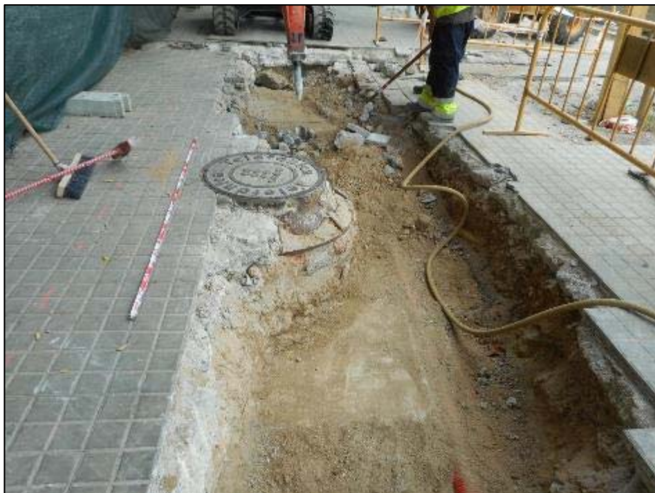
58. Tram de la rasa longitudinal, presència d'arqueta de servei telefònic i tubs d'amiant.
