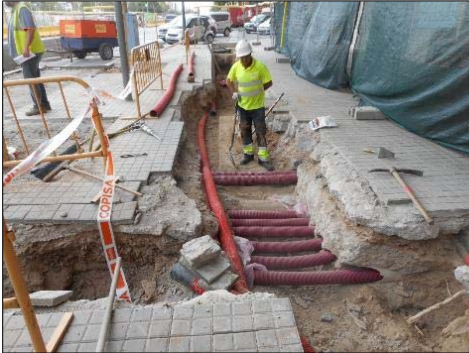
59. Substitució dels tubs d'amiant localitzats a tocar de l'arqueta de telefonia.
