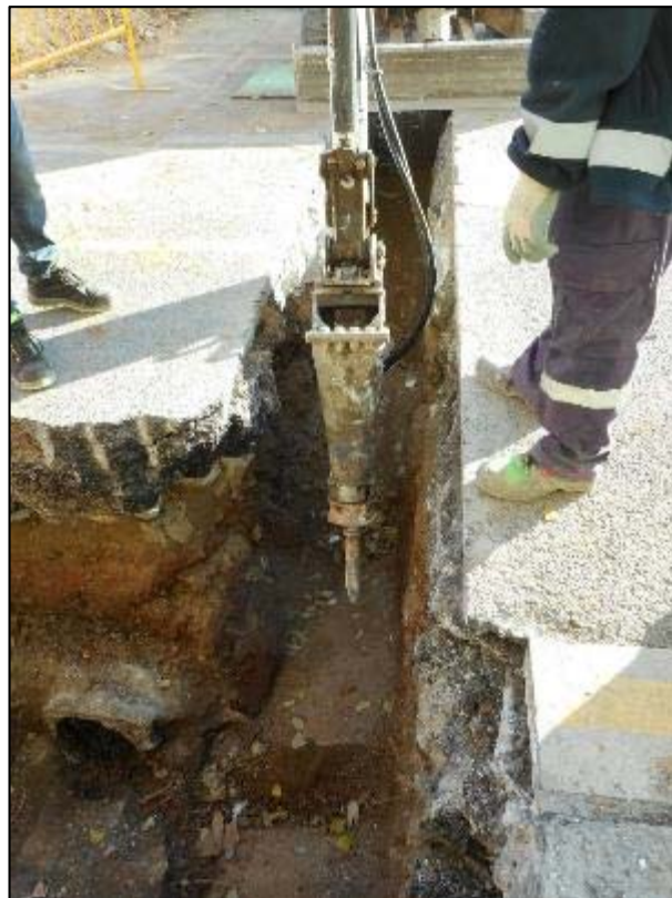
200.Desmuntatge parcial de la volta de l'estructura UE 040, Tram Sud del Rec Comtal.
