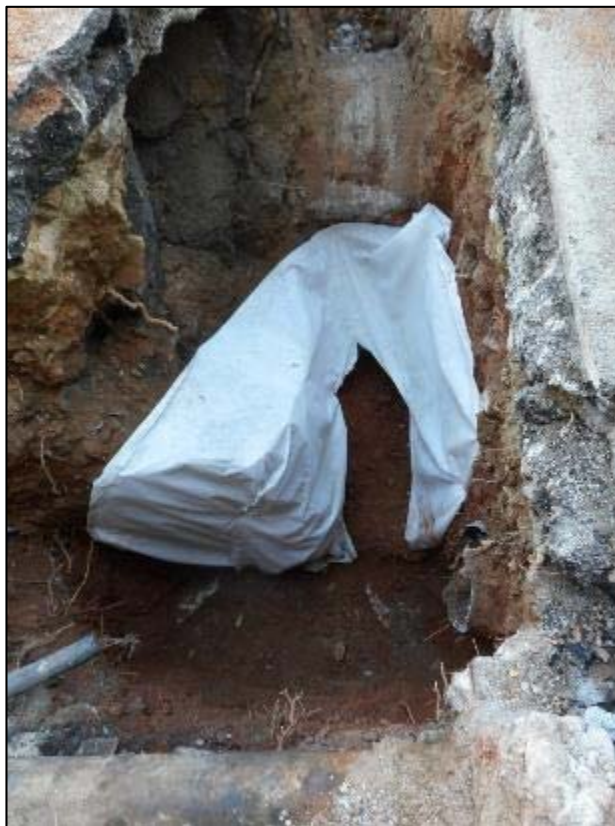
211.Cala 9, cobriment amb geotèxtil de l'estructura del Tram Sud del Rec Comtal.
