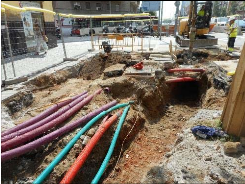
241. Obertura d'un traçat alternatiu davant l'abundant presència de serveis i boca de metro antiga.
