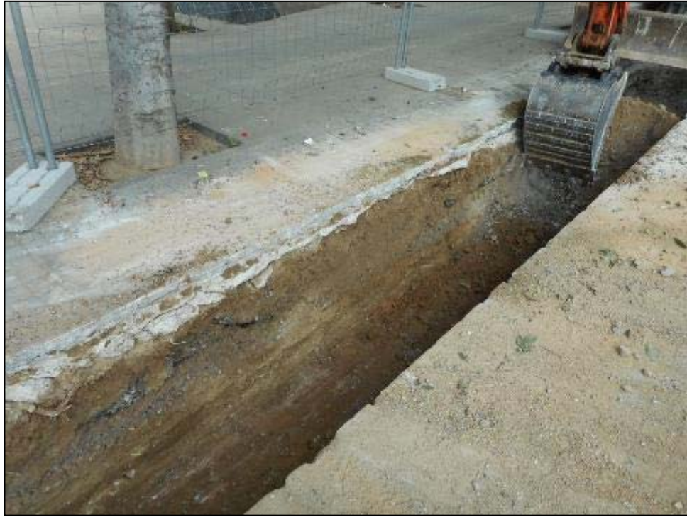
105. Rasa longitudinal, tram a tocar de la plaça del Doctor Serrat, màquina realitzant treballs.
