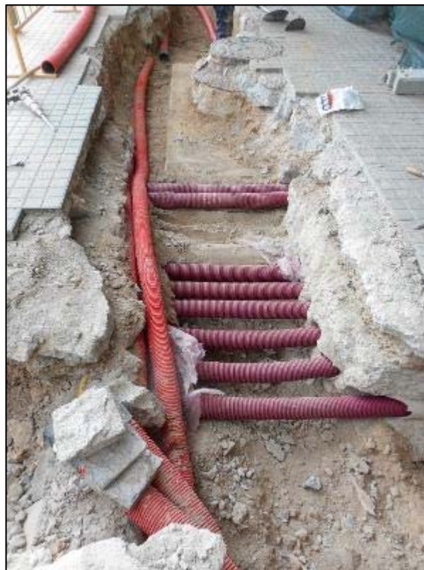
60. Substitució dels tubs d'amiant localitzats a tocar de l'arqueta de telefonia, detall.
