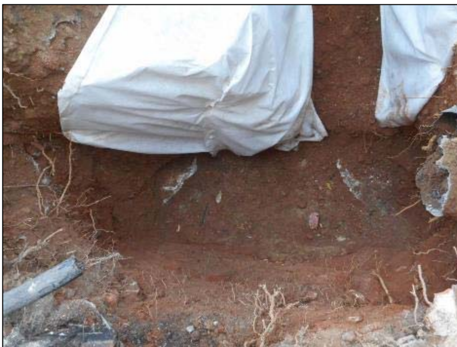
212.Cala 9, cobertura amb geotèxtil de l'estructura del Tram Sud del Rec Comtal.
