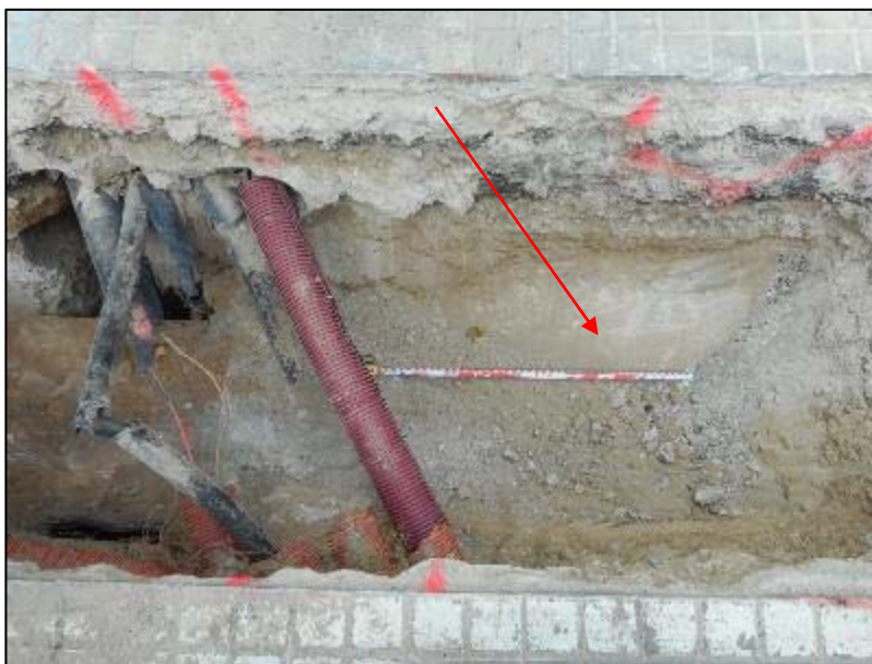
Detall de l'inici de la localització del sostre de la canalització del Rec Comtal en el creuament del Carrer Mallorca amb Meridiana.
