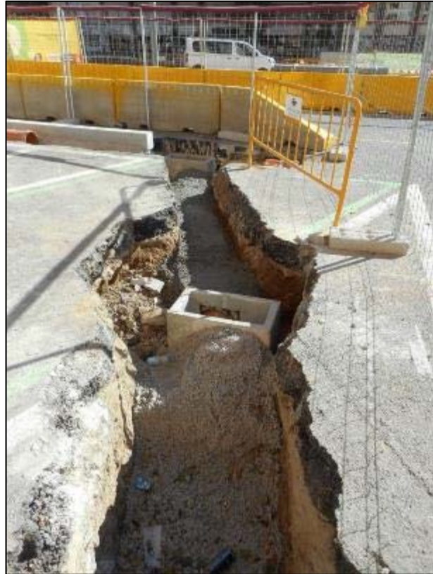
259. Rasa de connexió a la cala 2 en el tram entre els carrers del Consell de Cent i de la Independència.
