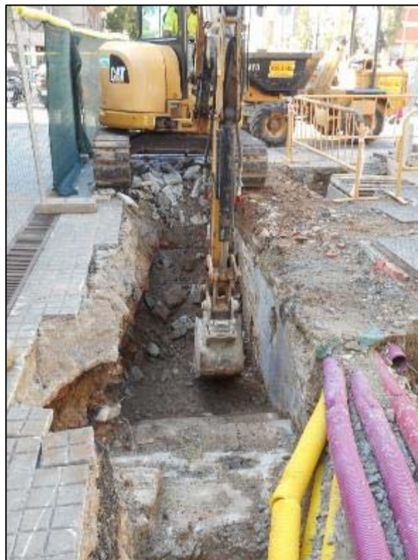
228. Obertura de la rasa a la zona de les escales UE 008 documentades durant les cales inicials.
