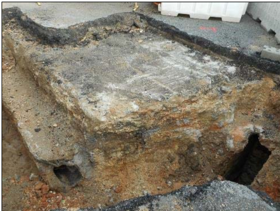
243. Localització de traçat de clavegueram antic a la cantonada amb el Carrer d'Aragó.
