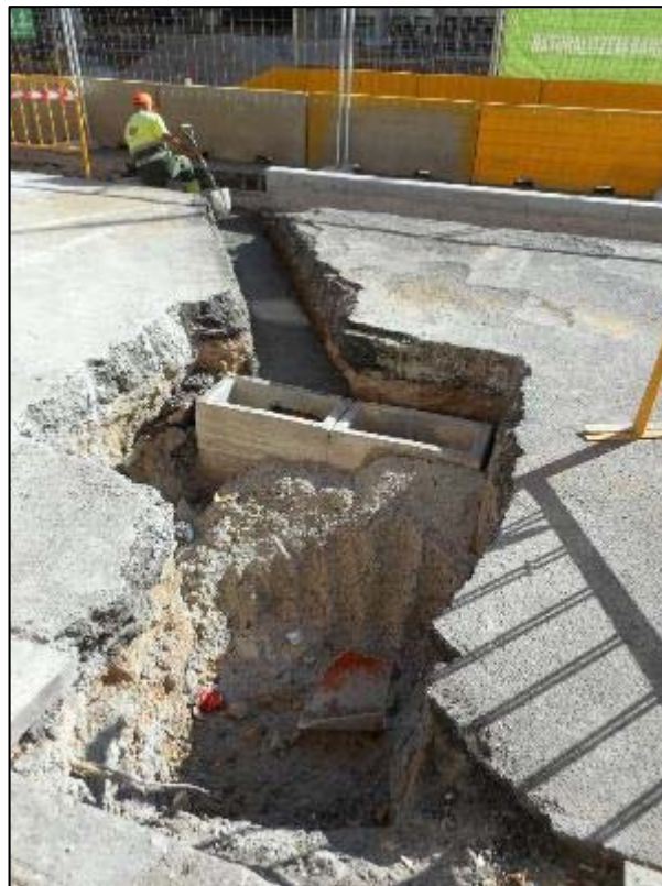
258. Rasa de connexió a la cala 6 en el tram entre els carrers del Consell de Cent i de la Independència.
