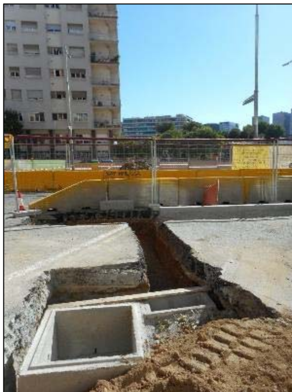
262. Rasa de connexió a la cala 3 en el tram entre els carrers del Consell de Cent i de la Independència.
