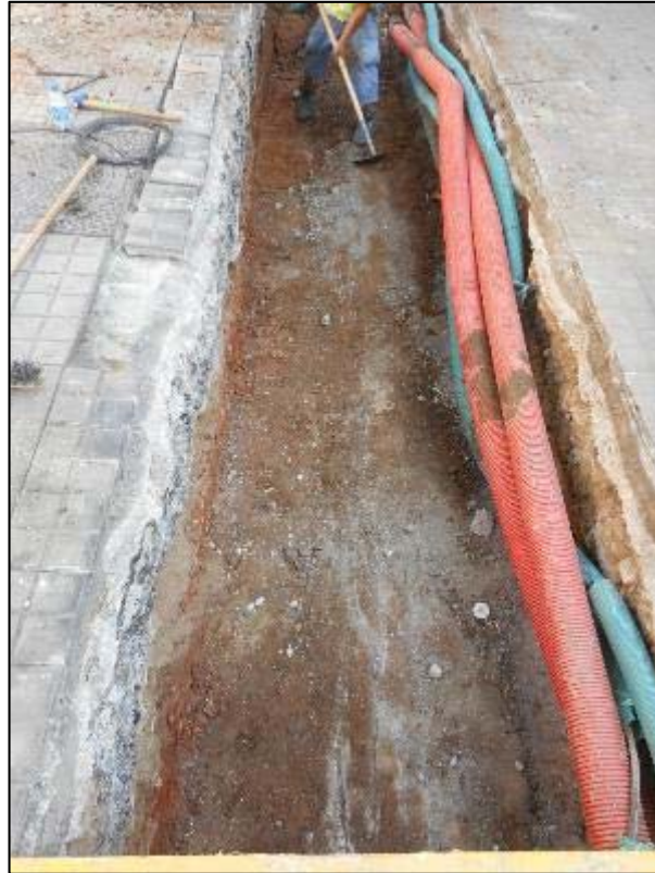
219. Col·lector UE 027 present al llarg de tot el recorregut de la rasa longitudinal, vorera de mar.
