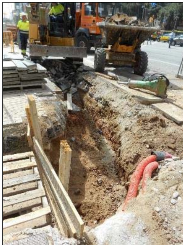
242. Obertura d'un traçat alternatiu davant l'abundant presència de serveis i boca de metro antiga.
