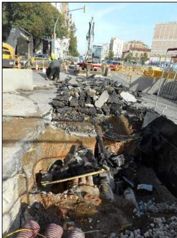
286. Obertura de rasa a la vorera de muntanya, creuant carrer d'Aragó direcció Nord.
